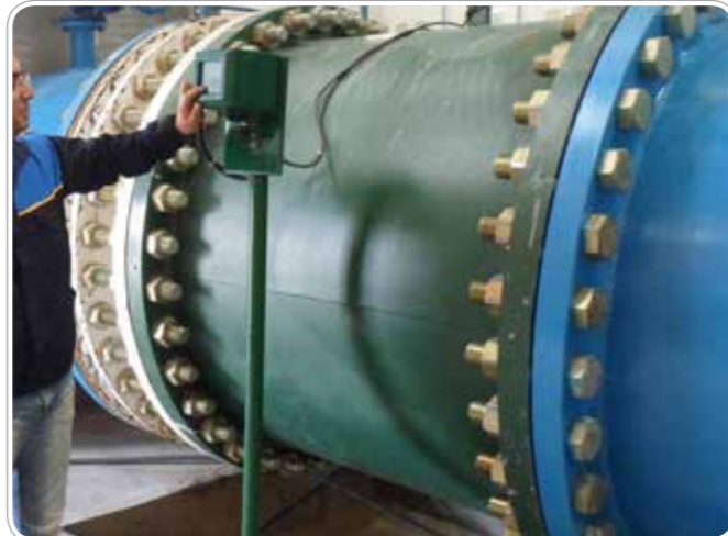
فلومتر ۱۴۰۰ میلی متری - سد کمال صالح (آب منطقه ای اراک - ۱۳۹۰)
